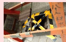
生涯学習センター フロアの陥没箇所
